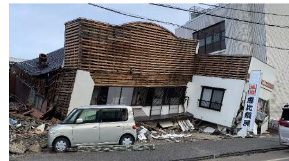
倒壊した旅館
