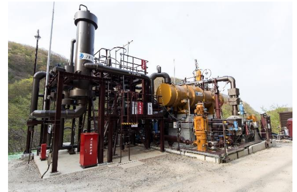
バイナリー発電設備
