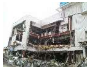
高田店の被災状況
