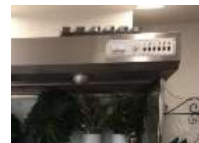
上部に位置する電気設備
