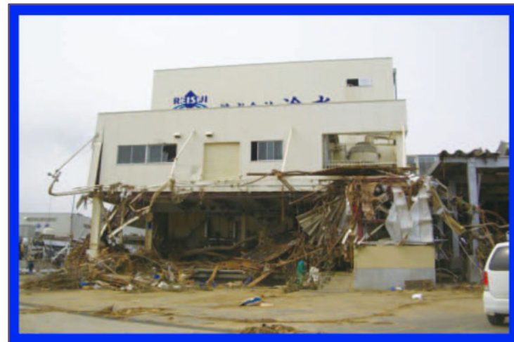
冷水 立体自動冷蔵庫
