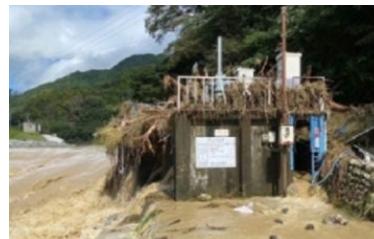
⑩興津川における取水障害 (静岡県静岡市清水区)
